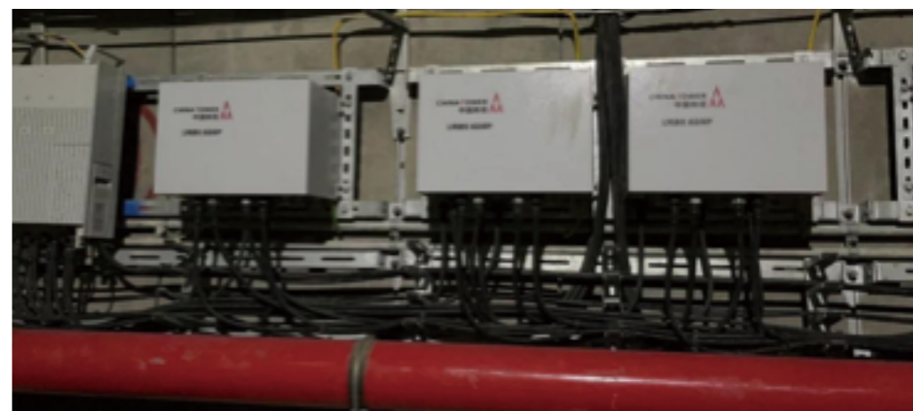
江苏铁塔助力南通地铁1号线实现三家运营商4G/5G信号的同步建设与开通
