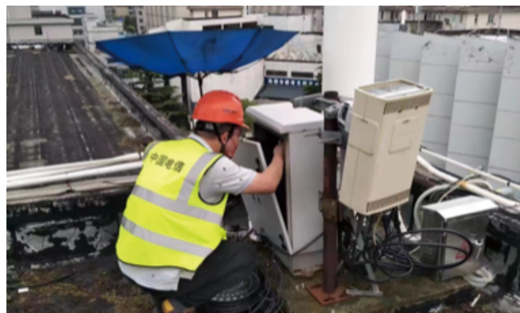
台风“梅花”登陆前,南通电信工作人员在对设备进行安全隐患排查
