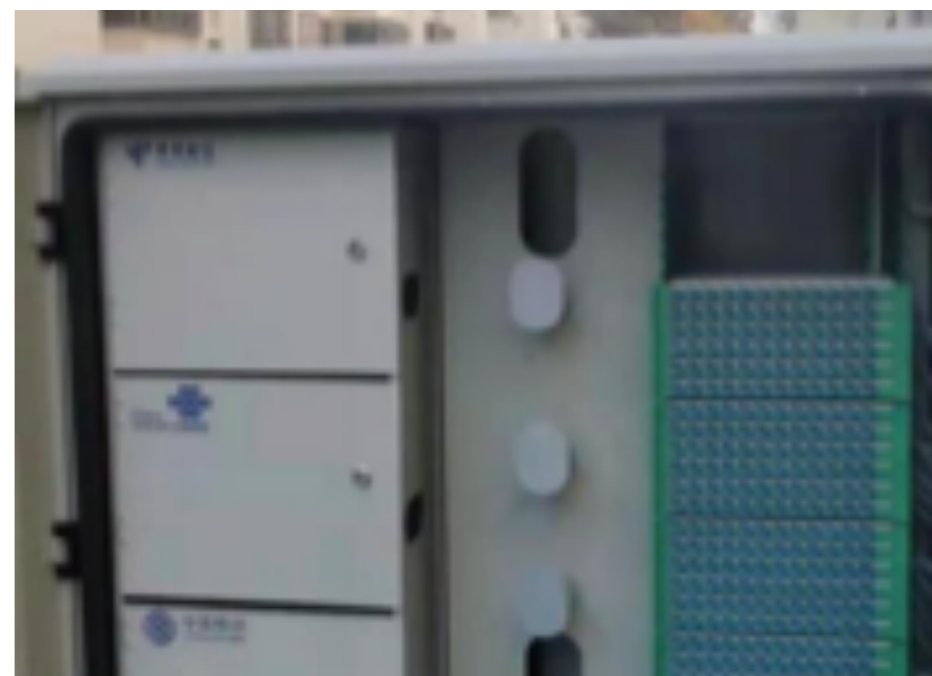
常州市北直街小区改造后的室外光缆交接箱
