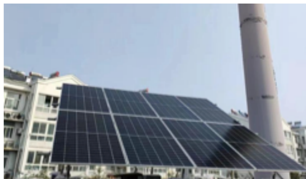
江苏铁塔光伏试点站能够实现机房降温、减低基站能耗
